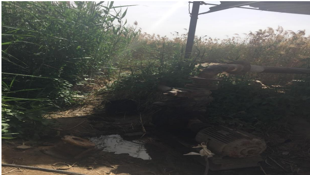
صورة رقم 3 ظلمبة نزح المياه الجوفية
