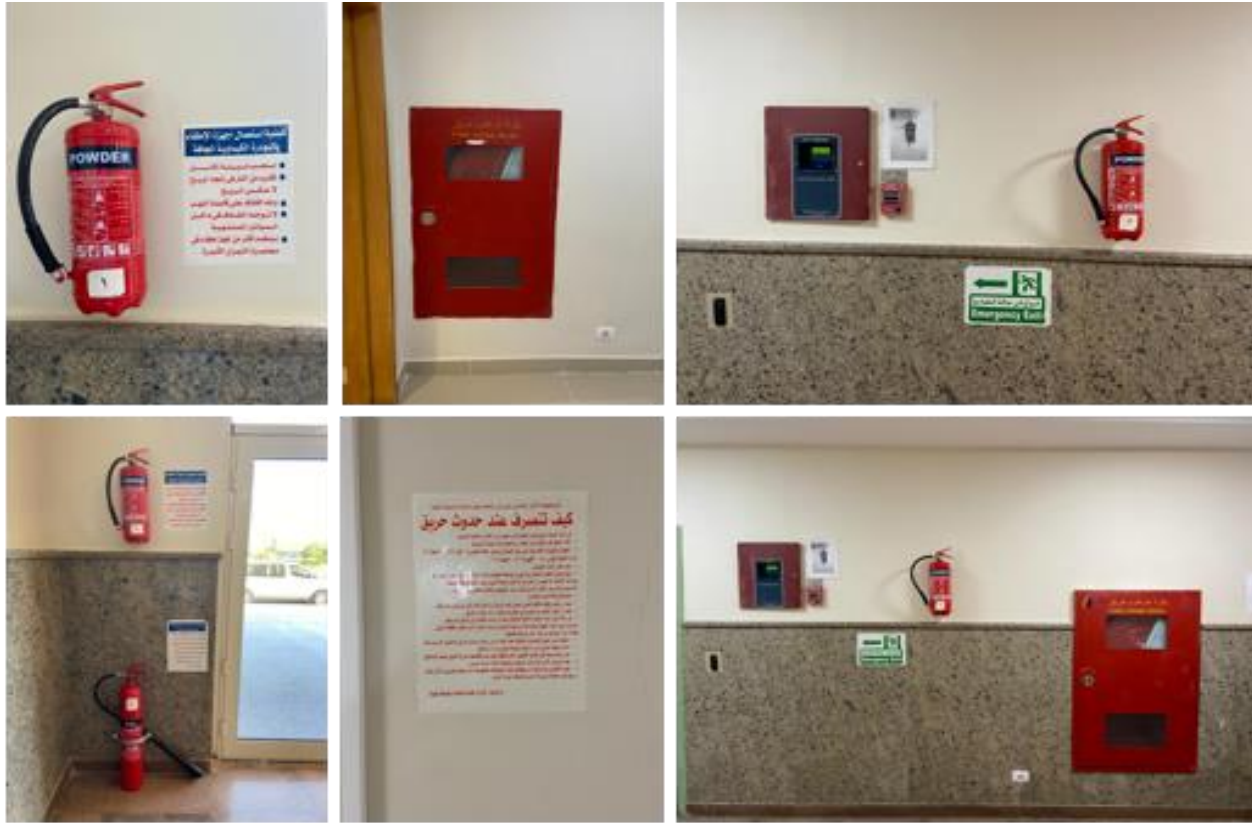
شكل 5: طفاية حريق و انذار حريق
